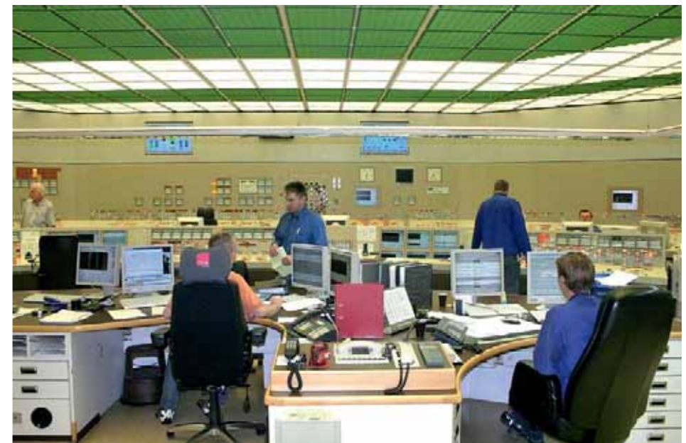
Atomkraftwerk Brokdorf: Die weiße Kuppel ist weithin sichtbar (oben). Im Kontrollraum (unten) müssen die Techniker fehlerfrei arbeiten. Fotos: Joachim Welding
